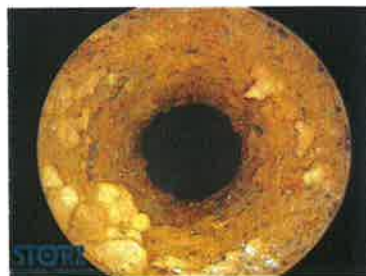
腐食した配管内部
