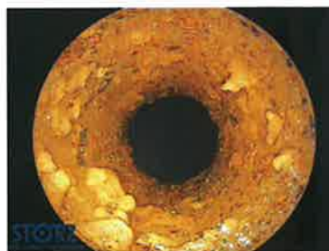
腐食した配管内部
